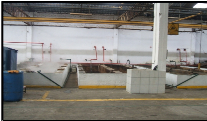
Figura 1.6: Tinas para Galvanizado
