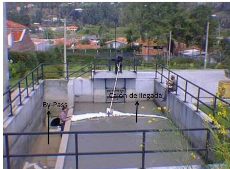
Figura 3.2: Cajón de llegada, By-pass y compuerta de admisión (ETAPA, 2007)
