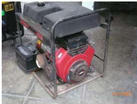
Figura 4.14: Generador de respaldo
