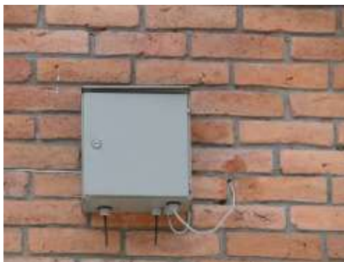
Figura 4.22: Acces Point ubicado en el bloque D
