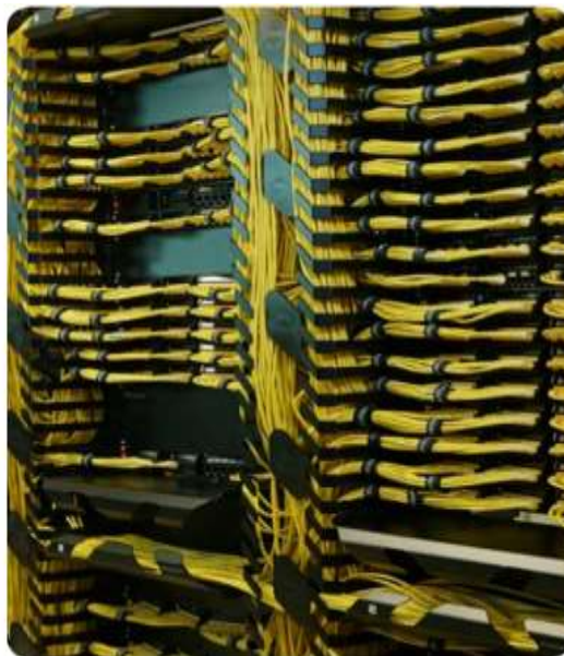
Figura 3.12: Disposición del cable dentro del Rack
