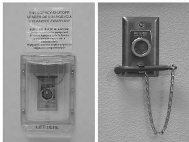
Figura 2.11: Controles de Emergencia de apagado
