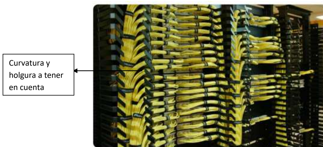
Figura 3.13: Rack para cable
