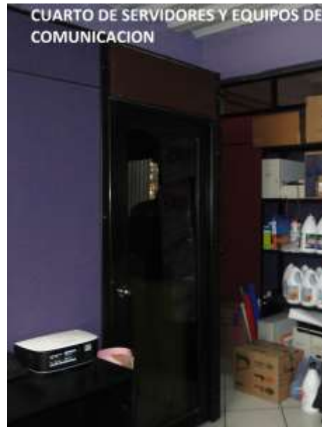
Figura 4.8: Cuarto de Servidores
