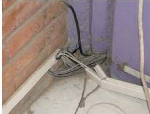
Figura 4.17: Estado del cableado
