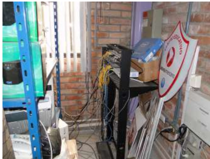
Figura 4.9: Interior del Centro de datos
