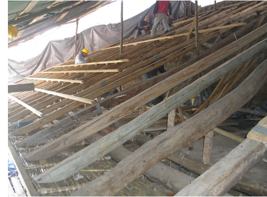
pares e implementación de correas, en sentido perpendicular a los pares, Iglesia de Todos Santos fotografía: la Autora
