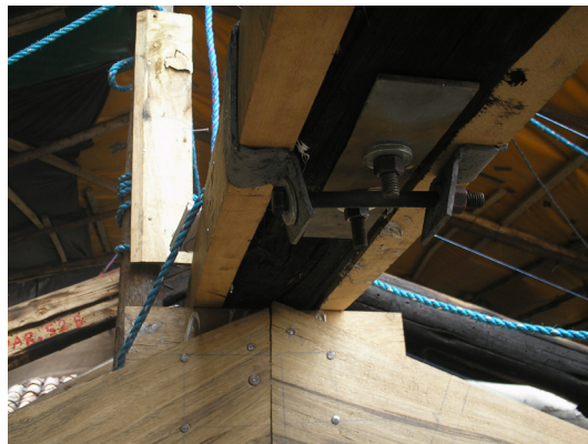
cumbbrero reforzado con piezas de madera nueva y con platinas de hierro, Iglesia de Todos Santos fotografía: la Autora
