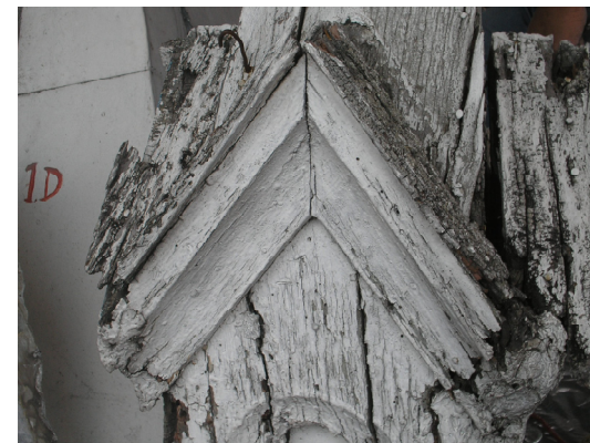
pináculo, expuesto a la intemperie, víctima del agua. Iglesia de Todos Santos.
