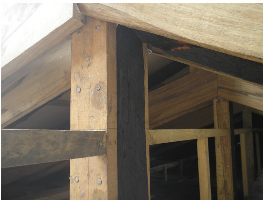
pendolón reforzado con piezas de madera nueva, Iglesia de Todos Santos fotografía: la Autora
