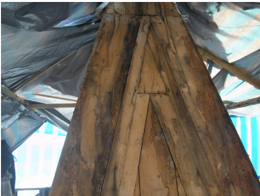
nivel 4, estado de la madera bajo la cubierta de latón fotografía: La Autora
