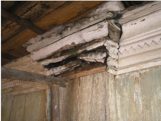
estado de las cornisas del nivel 1, desprendimiento de la madera, Iglesia de Todos Santos fotografía: la Autora
