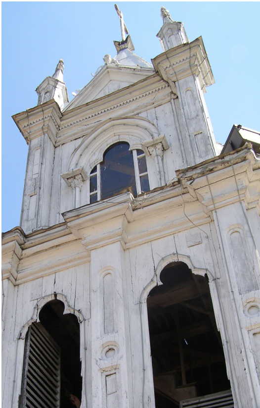
estado en el que se encontraba la Iglesia de Todos Santos antes de su restauración, archivo fotográfico, Diana Arias
