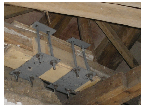
acoplamientos Fotografía: La autora
