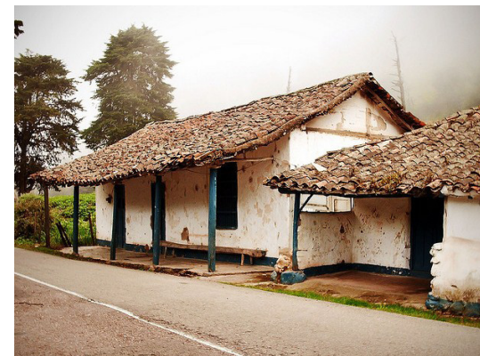
cubierta en mal estado fuente: www.farm3.static.flickr.com
