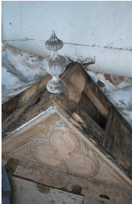
nivel 4, desprendimiento del latón para comprobar estado de la madera, molduras decorativas fotografía: La Autora
