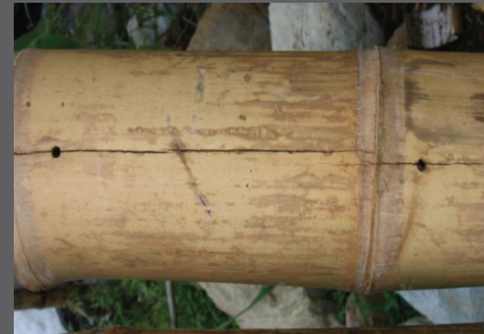
Imagen 92: Bambú con fisura
