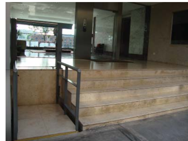
13. Salvaescaleras. (Pto. Madero-Bs. Aires-Argentina)
