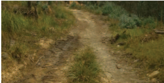
Estado Malo de la vía.
