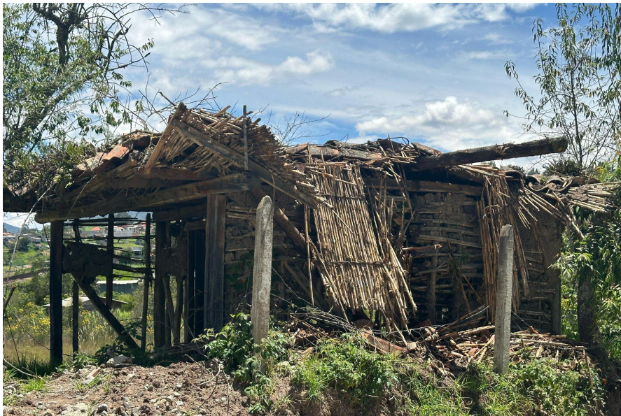
Fotografía 14. Ejemplo de edificación en mal estado de conservación.
