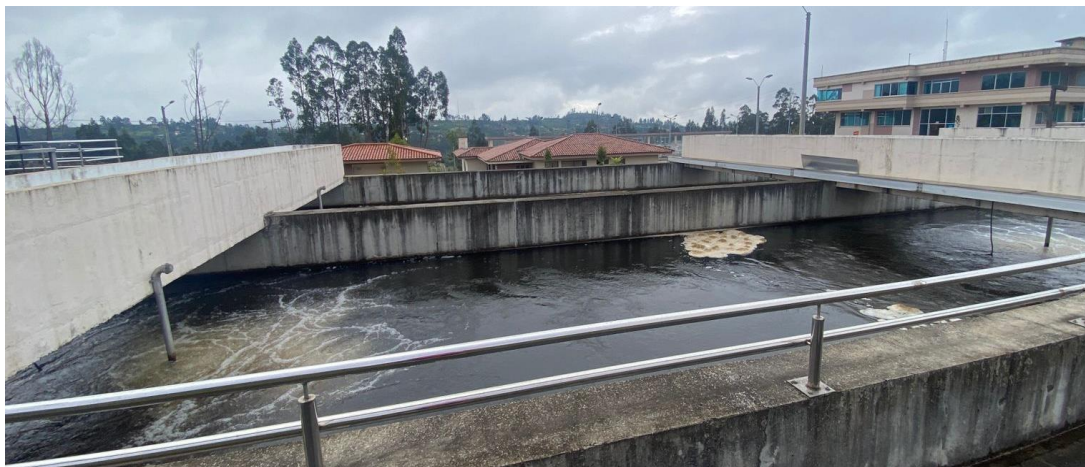
Figura 5. Vista lateral de los aireadores encendidos.
