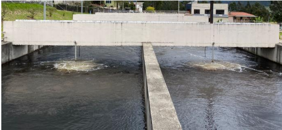
Figura 4. Vista frontal de los aireadores encendidos.
