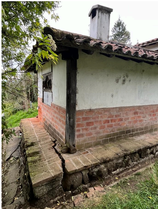
Figura 4.36 / Cocina de servicio (bloque 1) / Evidencia las piedras en la cimentación y las columnas de madera nativa. / Fuente: Juan Ignacio Serrano Suárez.
