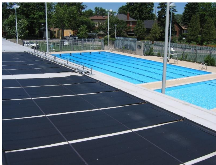
Figura 15. Colector sin cubierta.
