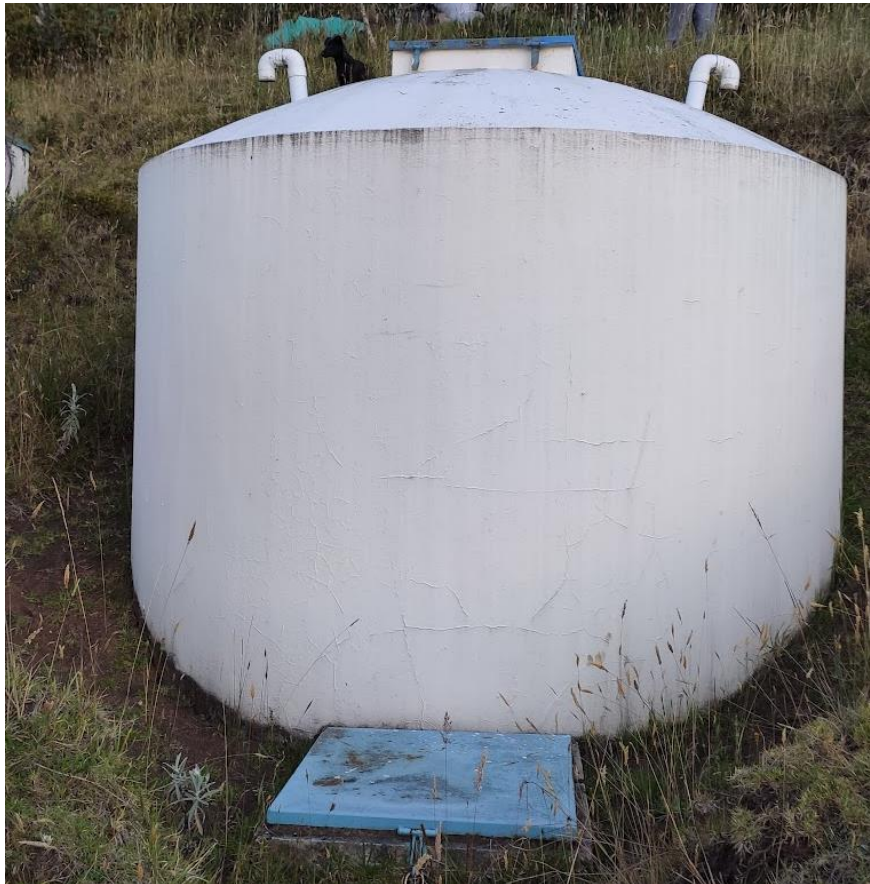
Figura 93 Tanque de reserva PTAP Chaguarcorral - Patapamba
