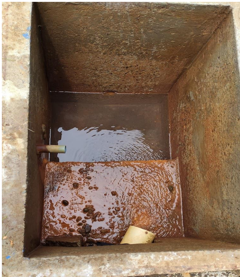
Figura 86 Cámara húmeda captación 2 - Chaguarcorral - Patapamba
