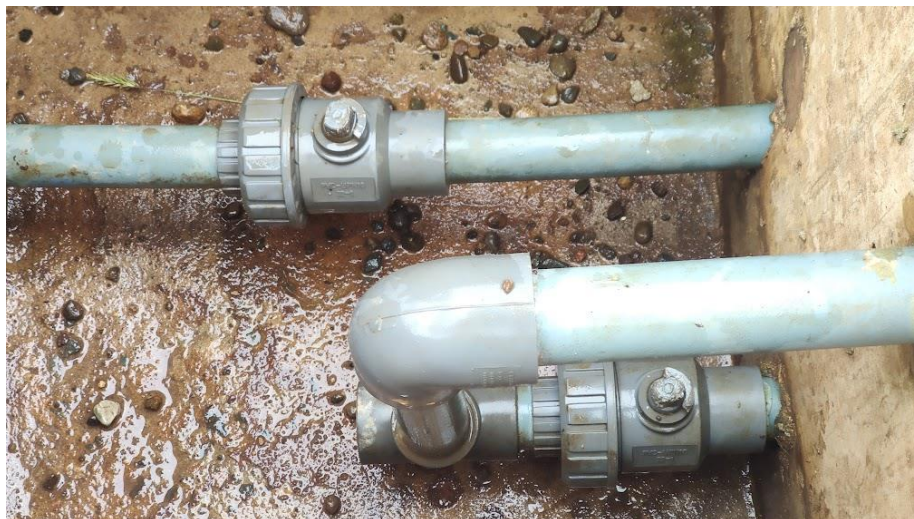
Figura 94 Cámara seca - captación 1 - Chaguarcorral - Patapamba
