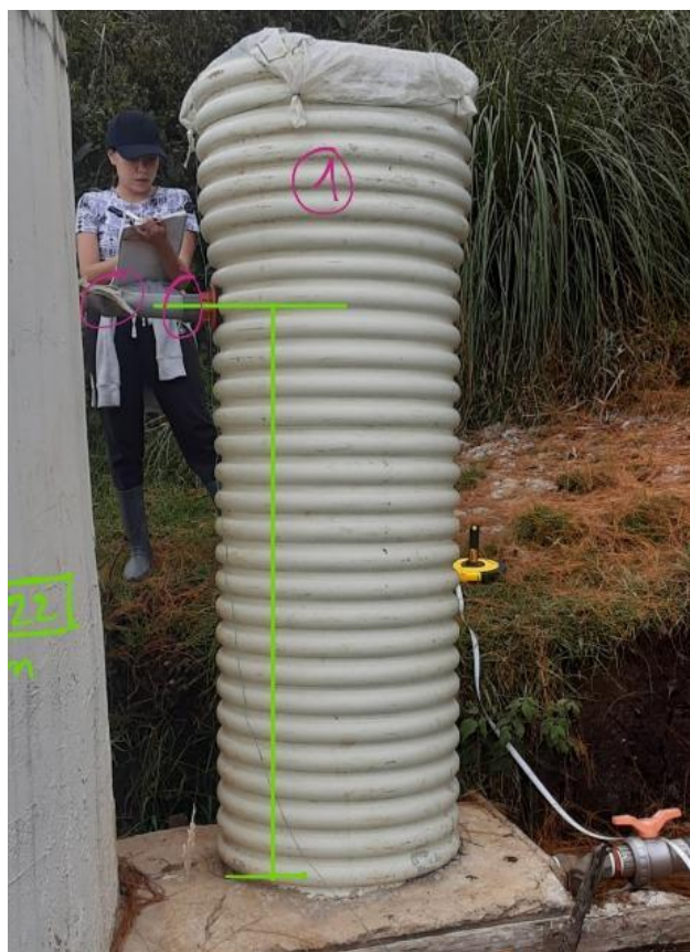
Figura 89 Filtro vertical PTAP - Chaguarcorral - Patapamba
