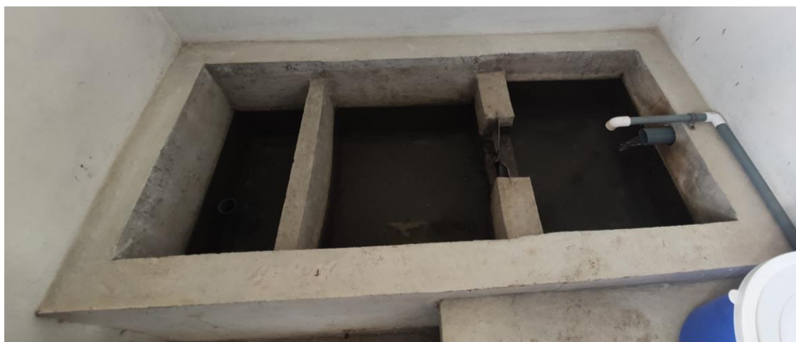
Figura 90 Vertedero de mezcla PTAP - Chaguarcorral - Patapamba
