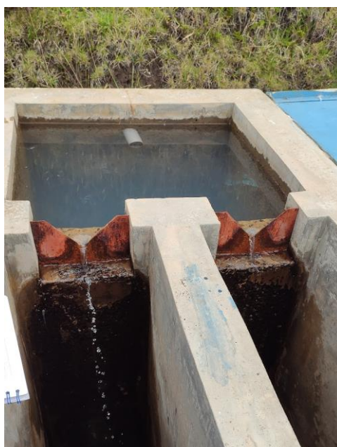
Figura 92 Vertedero repartidor - Chaguarcorral - Patapamba
