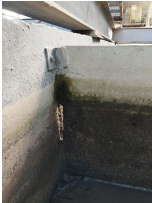
Figura 27. Fisuras en una de las pantallas del tramo 3 del sistema de floculación.
