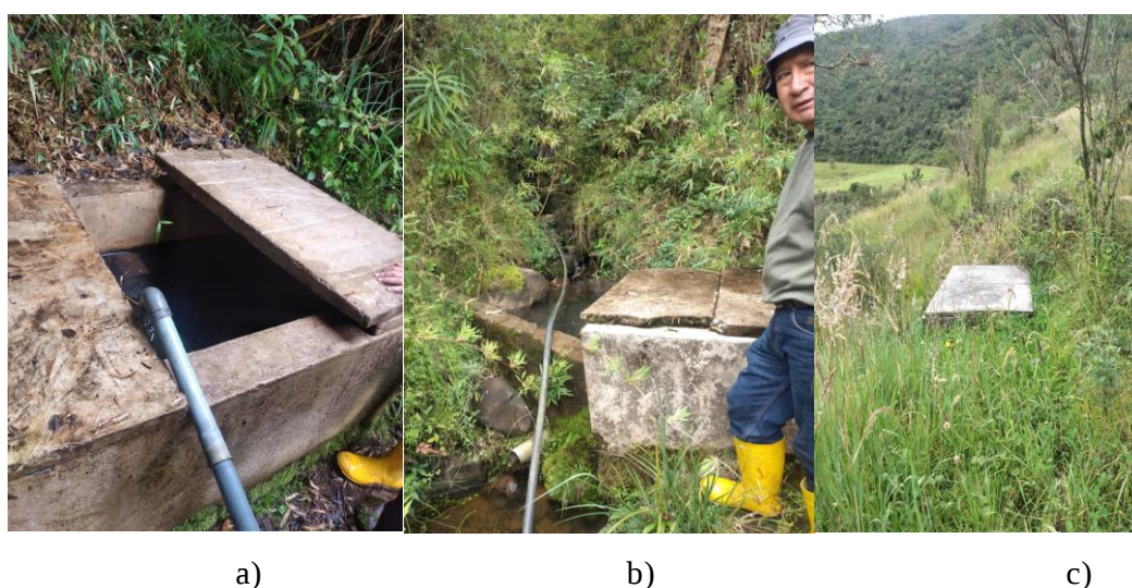
Figura 11. a) y b) Tanques de captación de las fuentes de agua superficial, c) Tanque de captación de la fuente de agua subterránea.
