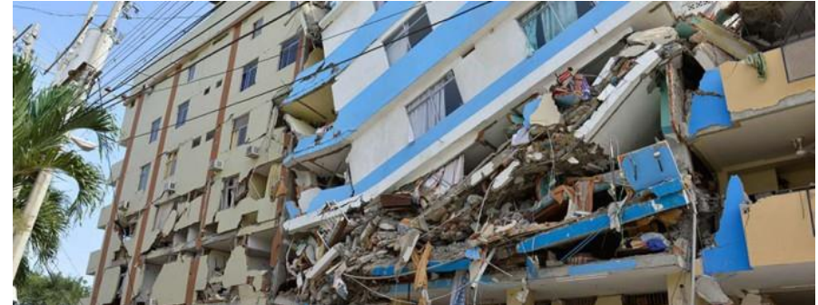
Figura 7 Daños producidos por el terremoto del 16 de abril del 2016
