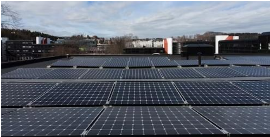
Gráfico 2.9 Implementación de paneles solares en la cubierta de Powerhouse Kjørbo
