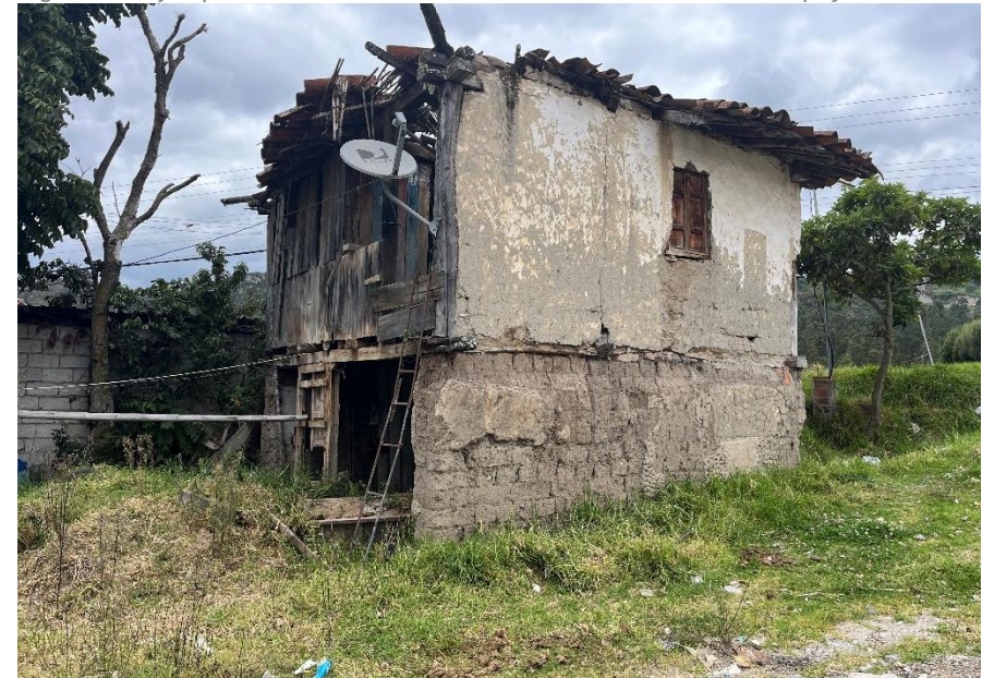
Figura 25. Ejemplo de edificación en estado de ruina en el barrio Allpayacu
