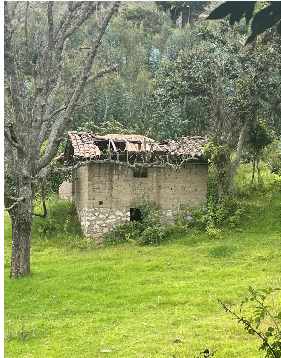
Figura 45. Ejemplo de vivienda abandonada con deterioro progresivo
