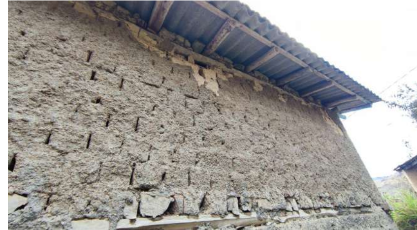
Figura 41: Erosión de muro de adobe.
