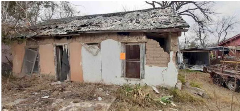
Figura 38: Vivienda de adobe con ausencia de mantenimiento
