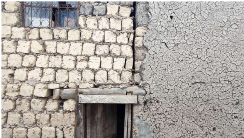
Figura 37: Muros no trabados en adobe.
