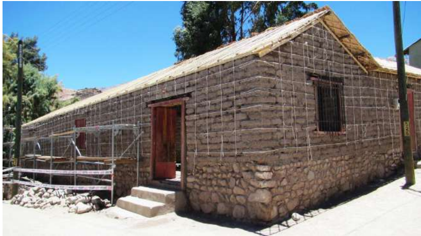
Figura 45: Vivienda reforzada con drizas.
