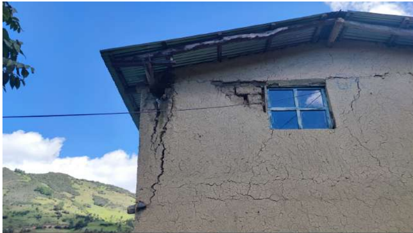
Figura 42: Grietas en muro de adobe.
