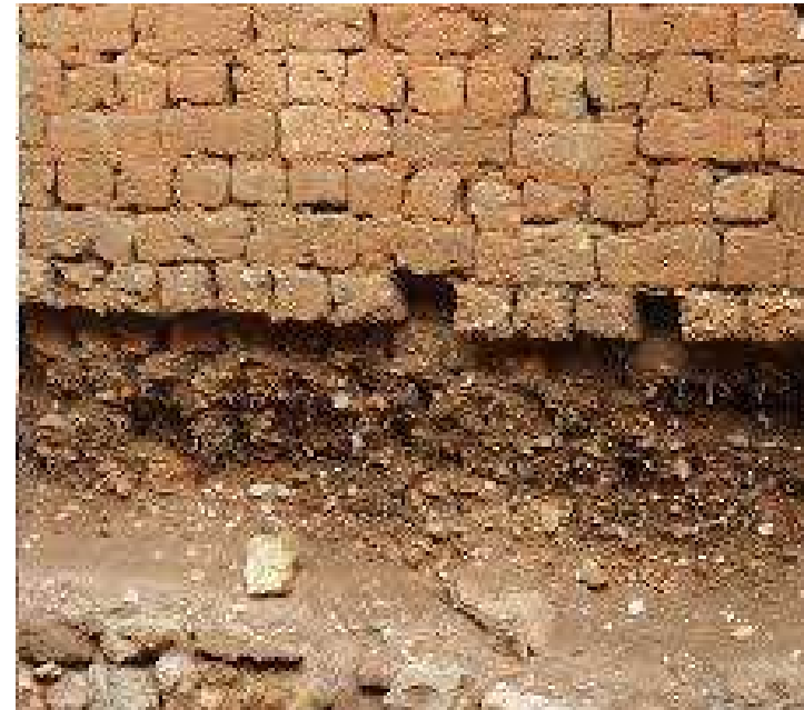
Figura 33: Problemas de erosión.
