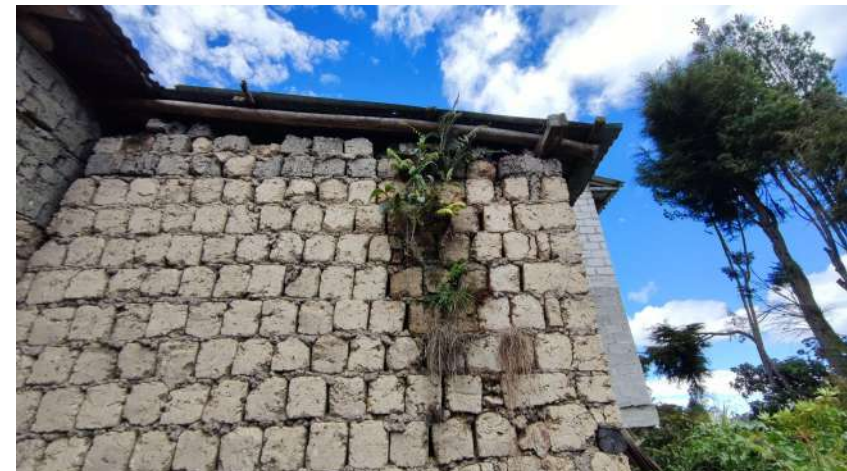
Figura 34: Daños provocados por acción vegetal.
