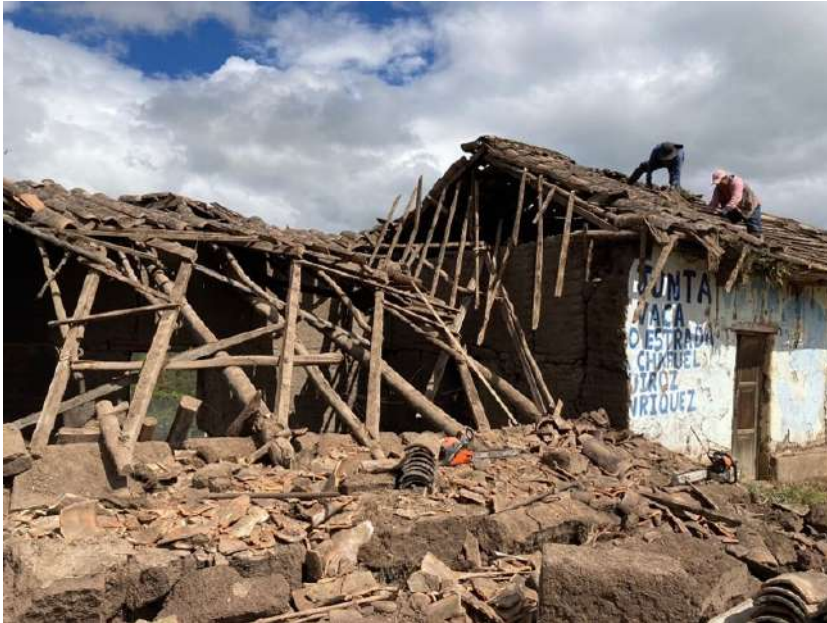
Figura 28: Vivienda de adobe afectada por un terremoto.
