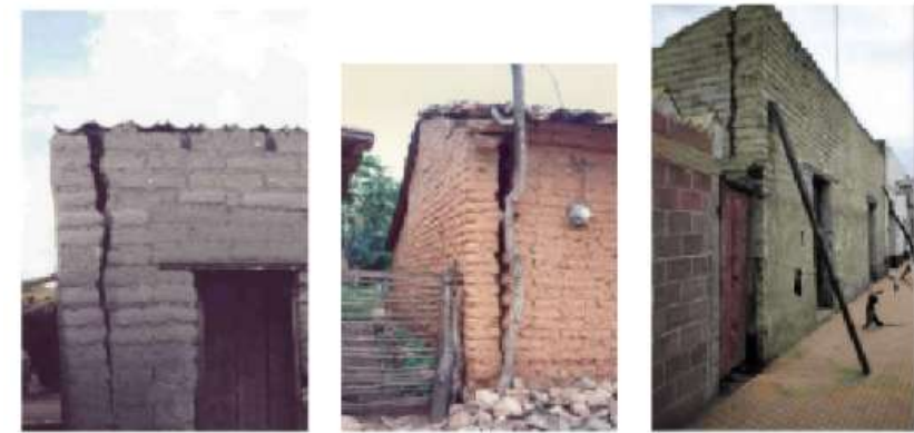
Figura 43: Desplome de muros de adobe.
