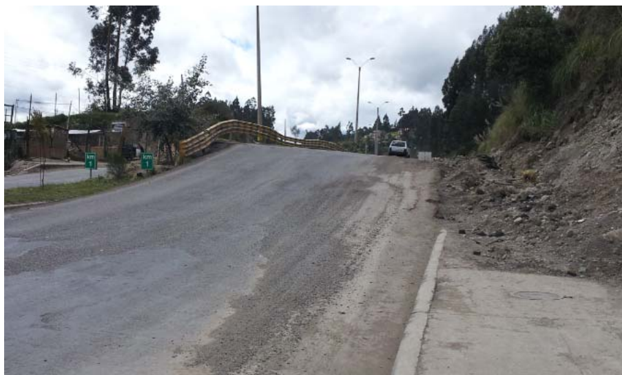
Anexo 1 Deformación de la calzada
