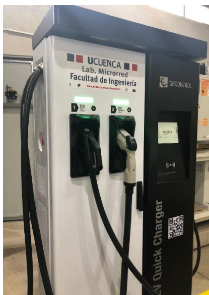
Figura 5. Estación de carga rápida para vehículos eléctricos.
