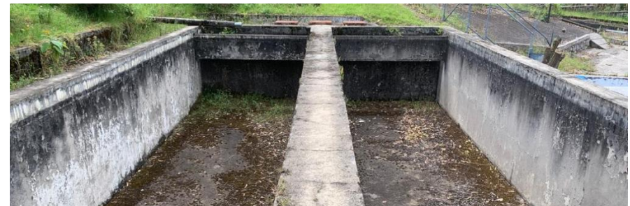
Figura 3.42: Estado actual de los tanques de tratamiento Fuente: Propia
