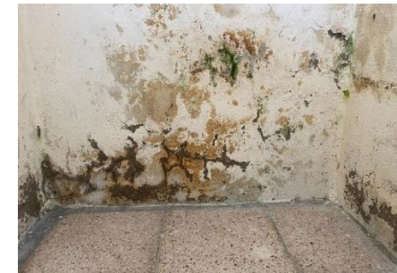
Figura 3.34: Humedad en las paredes. Fuente: Propia
