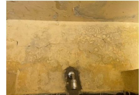
Figura 3.33: Grietas por asentamientos en las edificaciones. Fuente: Propia
