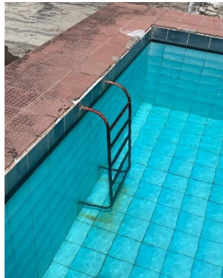
Figura 3.29: Estado actual de las escaleras de la piscina municipal de Girón. Fuente: Propia
