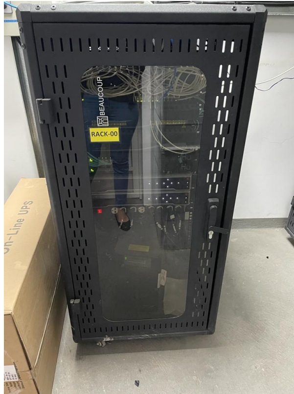
Figura A.4: Rack del Data Center
