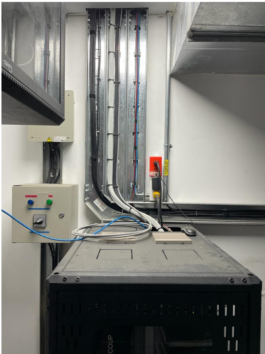
Figura A.1: Cableado desde el Data Center hasta los racks de distribución de cada piso
