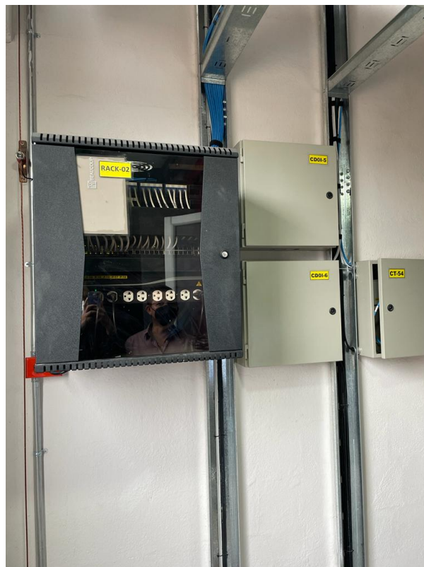
Figura A.3: Rack de Distribución
