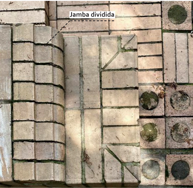
198 Jambas en pasamano de rampa escalerada (2022). Fotografía © Claudia Guerrero.
