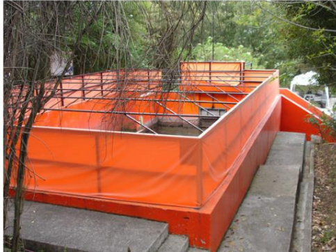
Fotografía 91 Cajón de Llegada-by pass-compuerta de admisión
