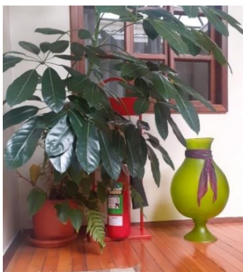
Fotografía 64 Ubicación de extintor de incendios Autores: Andrea Auquilla y Bibeca Erazo Fuente: Propia Fecha: 15 de febrero de 2022
