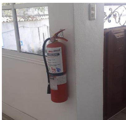
Fotografía 84 Extintor de incendios Autores: Andrea Auquilla y Bibeca Erazo Fuente: Propia Fecha: 03 de mayo de 2022
