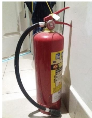
Fotografía 37 Extintor de incendios Autores: Andrea Auquilla y Bibeca Erazo Fuente: Propia Fecha: 01 de diciembre de 2021
