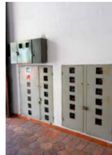
Fig. 122. Medidores de luz y agua.
