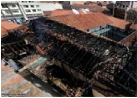
Fig. 51. Cubierta del Seminario San Luis tras incendio. Fuente: El Universo, 17 de agosto de 2012. https://www.eluniverso.com/2012/08/17/1/1447/incendio-dano-50-seminario-san-luis-edificio-patrimonial-cuenca.html/
