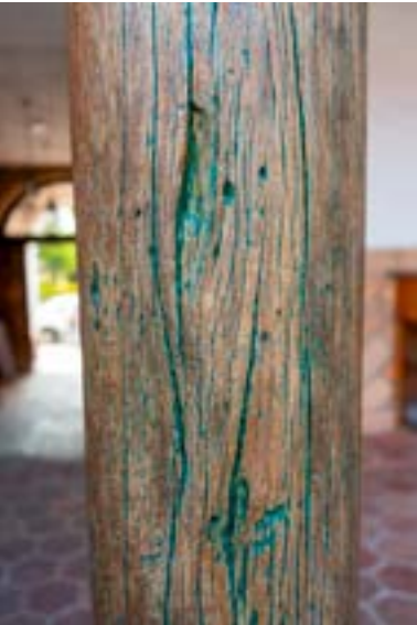
Fig. 106. Residuos de pintura verde en columnas.
