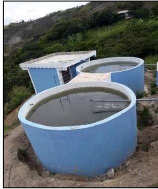
Imagen 5. Tanques de filtración lenta.
