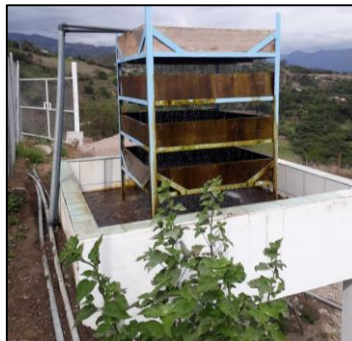
Imagen 4. Torre de aireación del agua.
