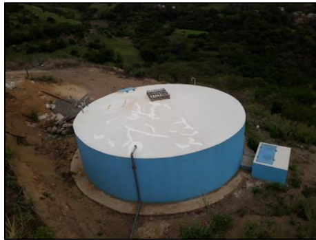
Imagen 8. Tanque de almacenamiento.
