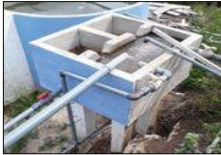
Imagen 3. Captación del agua.
