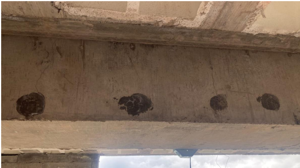
Figura 31: Ensayos sobre grietas y puntos intermedios para determinar la influencia
