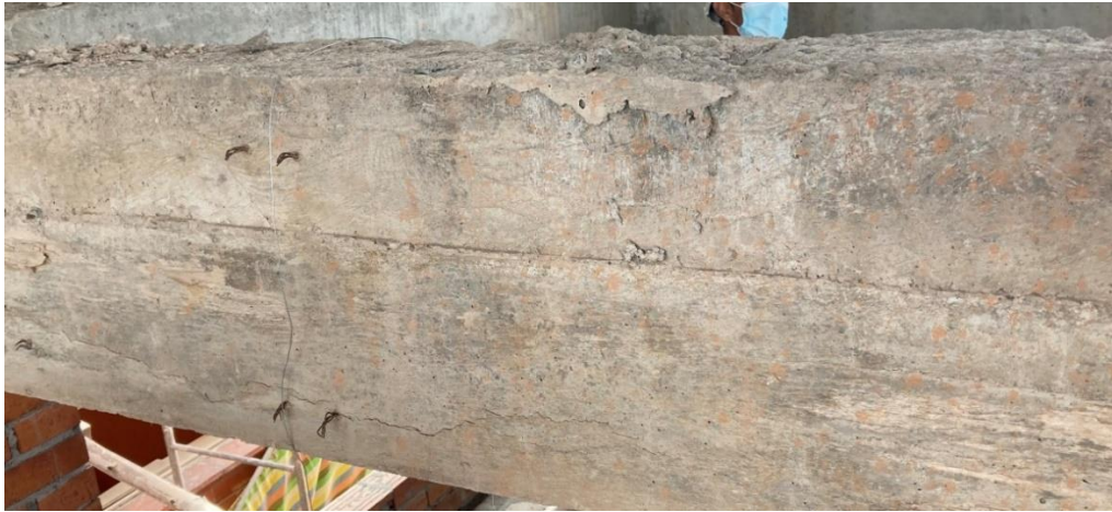
Figura 30: Determinación visual de estado de fisuración (Fisura Superficial)
