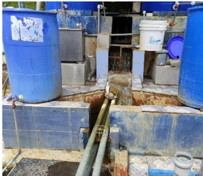
Ilustración 8 Punto de captación para el transporte de agua hacia los floculadores vertical y horizontal
