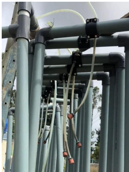
Ilustración 4 Válvulas de aire colocadas en la parte superior de los floculadores verticales debido a problemas con la circulación del agua por presiones negativas
