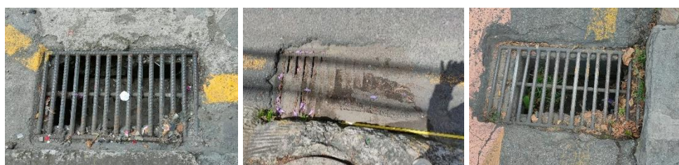
Ilustración 5. Estado de los imbornales.
