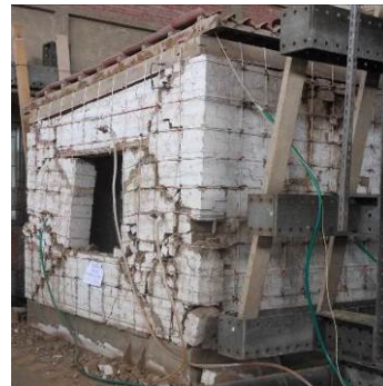
b) Daños en el ambiente de adobe
