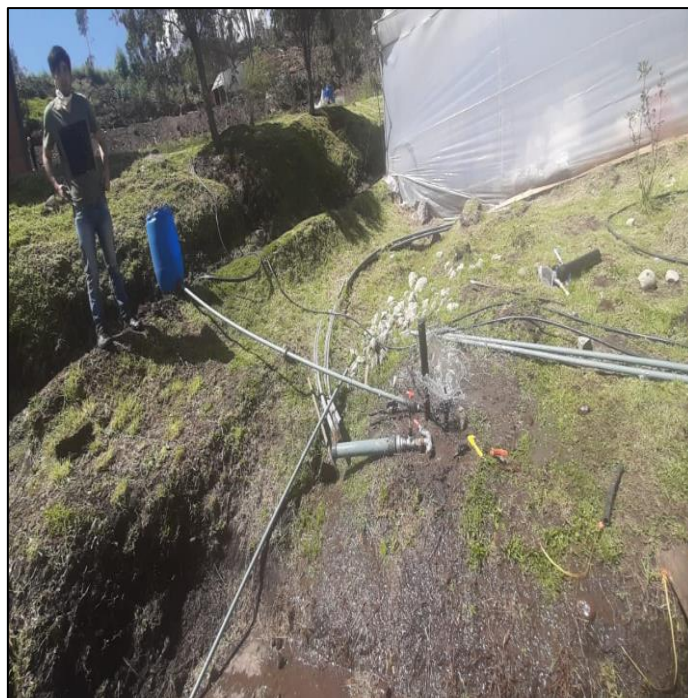
Anexo 5: Ariete hidráulico en funcionamiento
