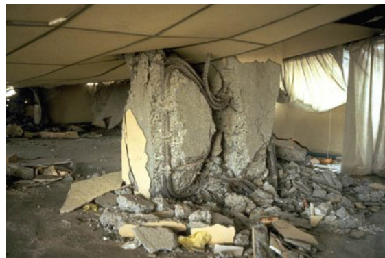
Fig 34. Falla en columna de hotel Terminal debido a terremoto.
