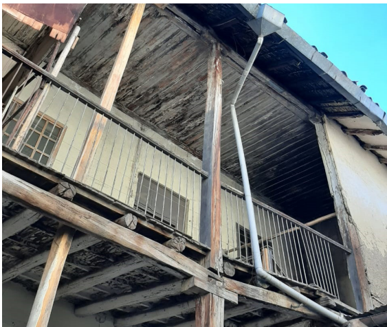
Fig 264. Balcón del patio posterior, vigas y columnas dañadas por presencia de agua. Fuente: Propia, 2020.
