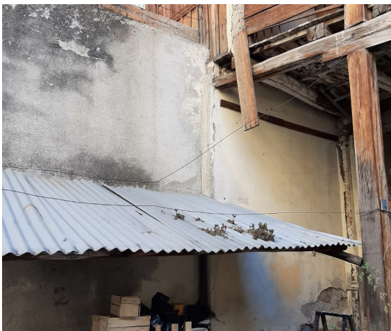
Fig 265. Balcón del patio posterior, vigas y columnas dañadas por presencia de agua. Presencia de materiales incompatibles como el cemento. Fuente: Propia, 2020.
