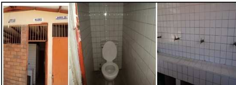
Foto No. 11, 12, 13: Infraestructura sanitaria.
