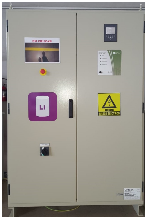
Figura 2.3: Banco de baterías de Ion-Litio
