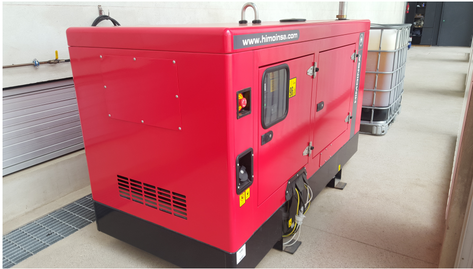
Figura 2.2: Generador a diésel / grupo de electrógeno a diésel
