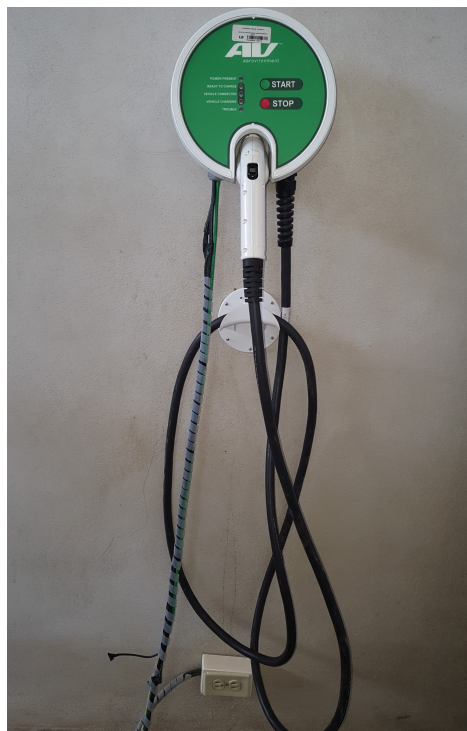
Figura 2.5: Estación de carga
