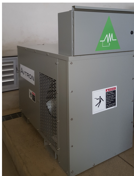
Figura 2.4: Carga resistiva trifásica programable
