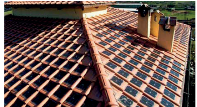
Imagen 2.24: Tejas fotovoltaicas sobre cubierta
