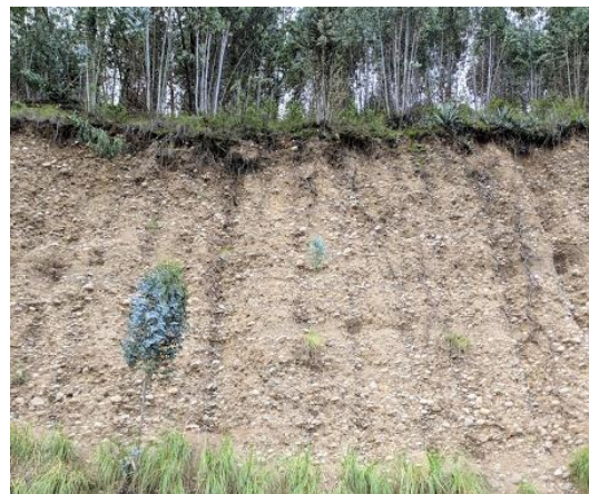
Figura 1. Talud afectado por la erosión hídrica.
