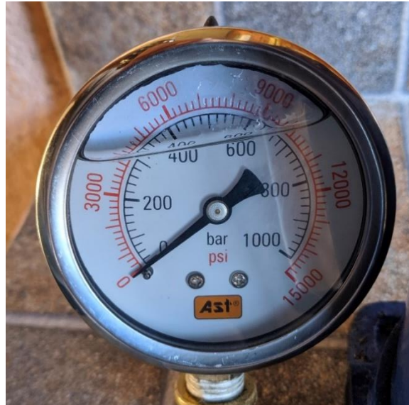
Figura 25. Manómetro instalado en los gatos hidráulicos.
