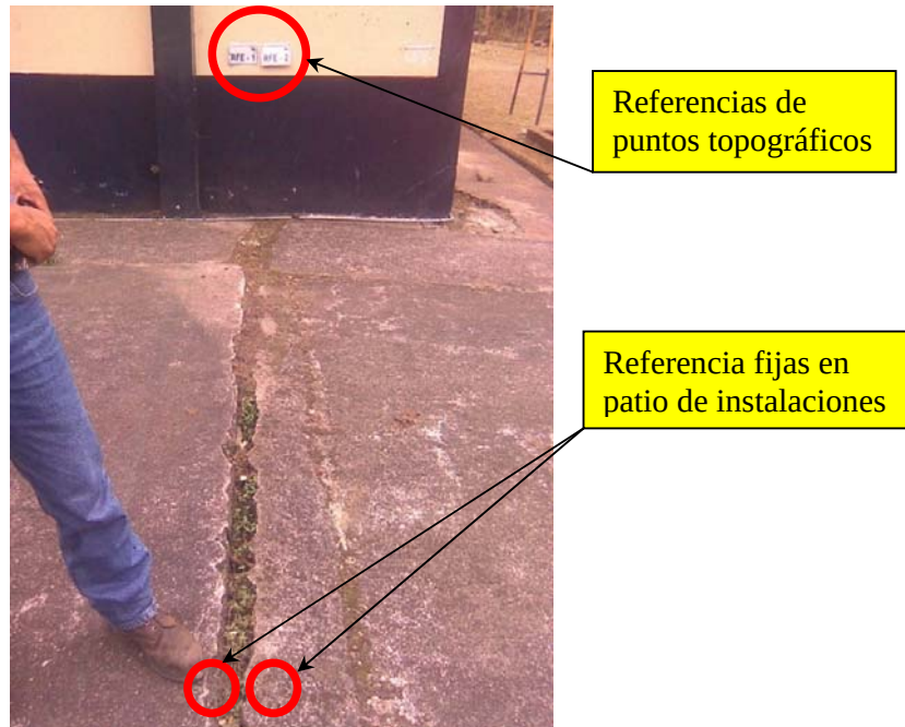
FOTO No 3: Referencias Fijas y evidencia de movimientos, observamos junta muy abierta. (Fotografías tomadas en campo, en visitas técnicas para el desarrollo del presente trabajo investigativo).
