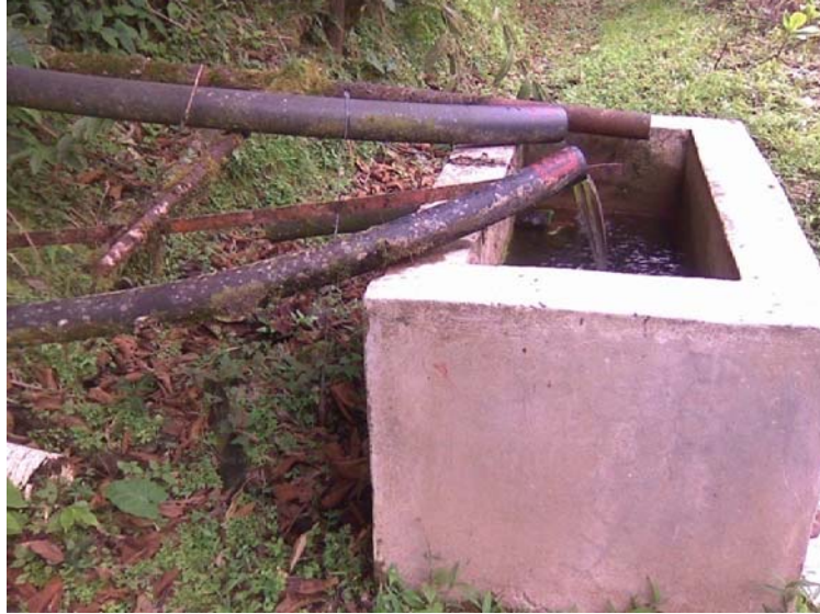
FOTOGRAFIA No 5: RECUPERACION Y MEDICION DE CAUDALES A TRAVÉS DE DRENES SUBHORIZONTALES. (Fotografías tomadas en campo, en visitas técnicas para el desarrollo del presente trabajo investigativo).
