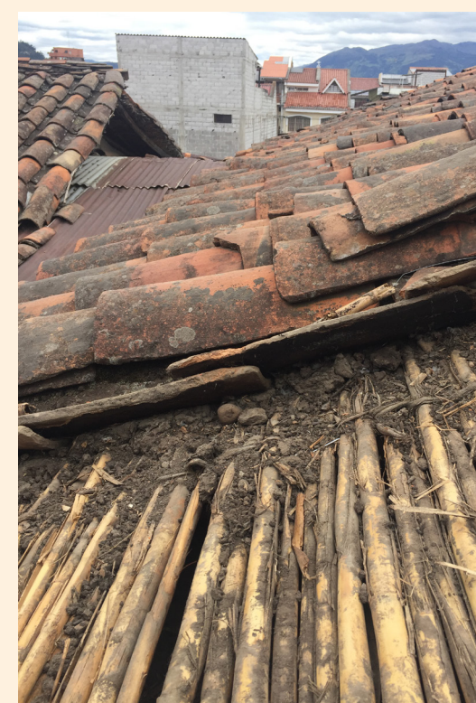
Fig. 89: Cubierta, vivienda vernácula aportalada 0102033024. Elaboración: Propia.
