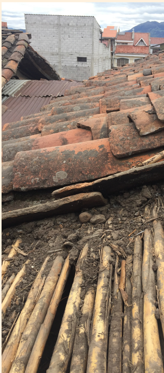
Fig. 17: Calle Las Herrerías, enchagcleado en cubierta. Elaboración: Propia
