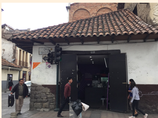
Fig. 65: Vivienda vernácula simple 0102041045, dintel. Elaboración: Propia
