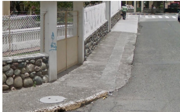
Fig 104. Acera en estado regular. Cortesía Google, 2015.
