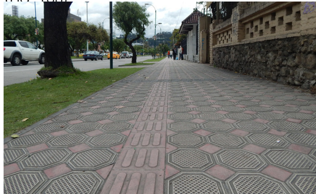
Fig 102. Acera en excelente estado. Autores, 2018.
