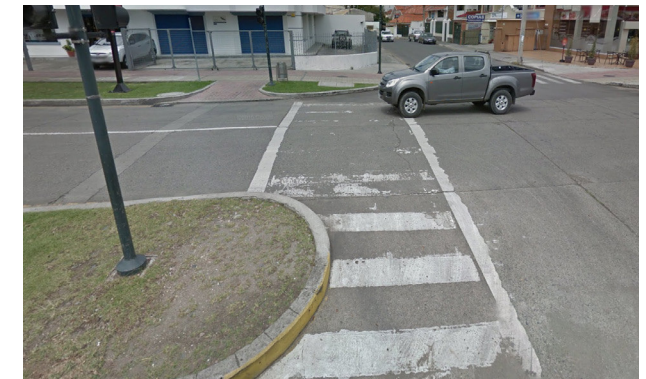
Fig 29. Rampa desplazada del cruce. Cortesía de Google, 2015.
