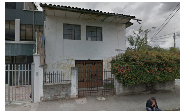
Fig 79. Edificación estado precario. Cortesía Google, 2015.
