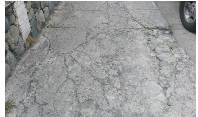
Fig 105. Acera en mal estado. Autores, 2018.
