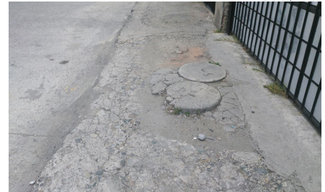
Fig 106. Acera en pésimo estado. Autores, 2018.
