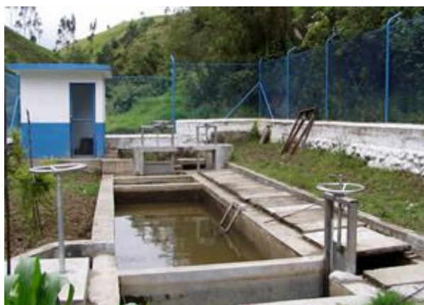
Fig. 7 Captación de Nudpud (Emapal Ep, 2016)
