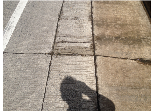
Rotura en las esquinas de paño y cuña
