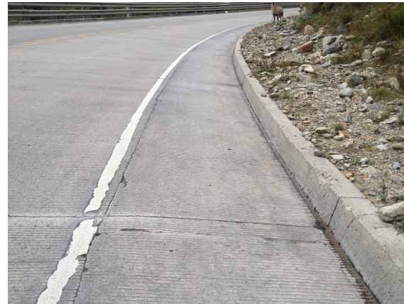
Fisura Transversal en cuneta
