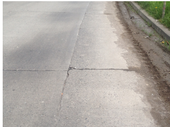
Despostillamiento esquina cuneta
