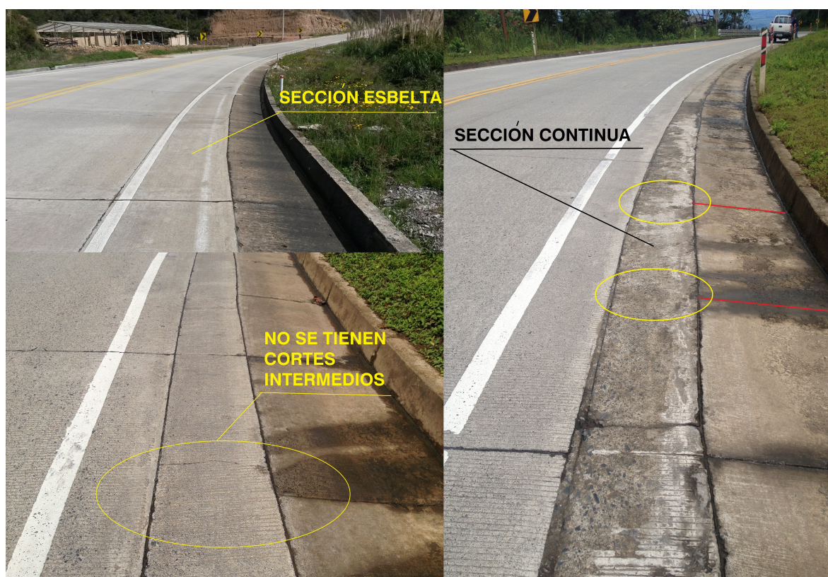
Figura 63: Fotos de sobreanchos demasiado largos.
