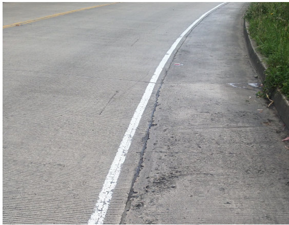
Desgaste zona de sobreancho.
