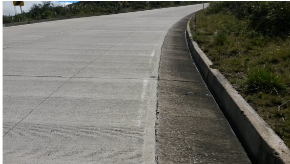
Desgaste zona de sobreancho.
