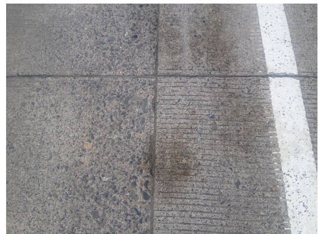
Pulimiento de calzada diferente de cuneta
