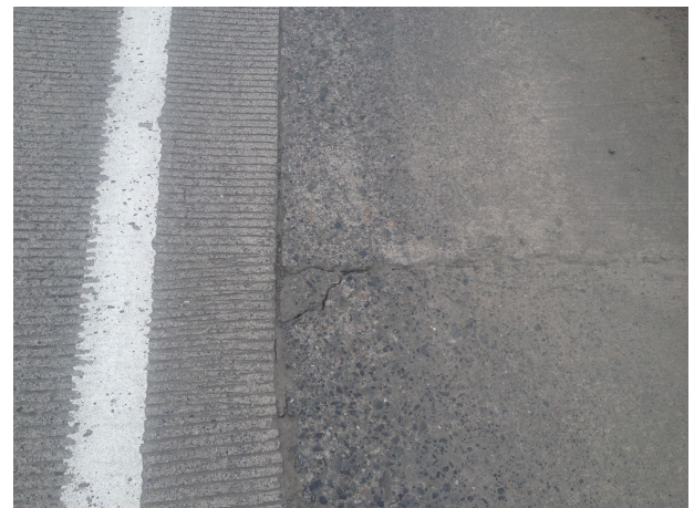
Rotura en esquina con pulimiento
