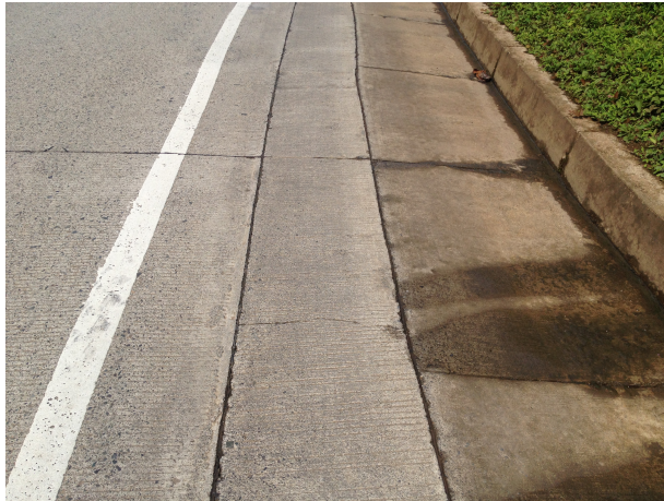
Fisura transversal en cuña.
