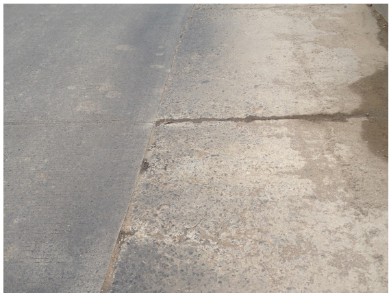
Pulimiento y despostillamiento sobreancho
