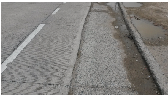
Fisura Transversal en cuneta
