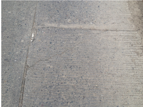
Fisura esquina en cuneta zona sobreancho.
