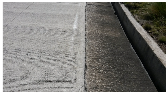
Fisura Transversal en cuneta
