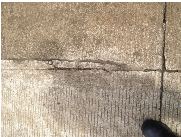
Rotura al inicio de cuña
