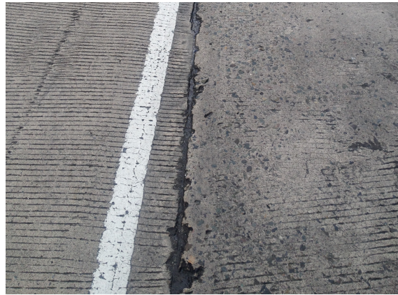
Despostillamiento sobreancho cuneta
