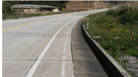
Despostillamiento sobreancho cuneta
