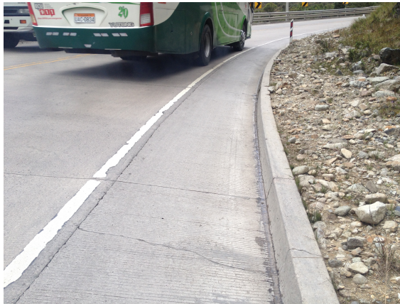
Fisura Transversal en cuneta
