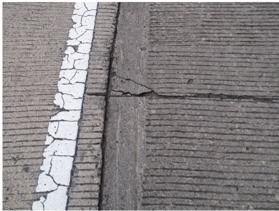
Rotura de esquina sobreancho
