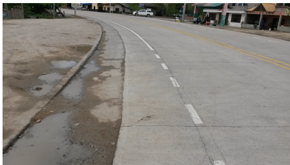
Rotura de esquina sobreancho
