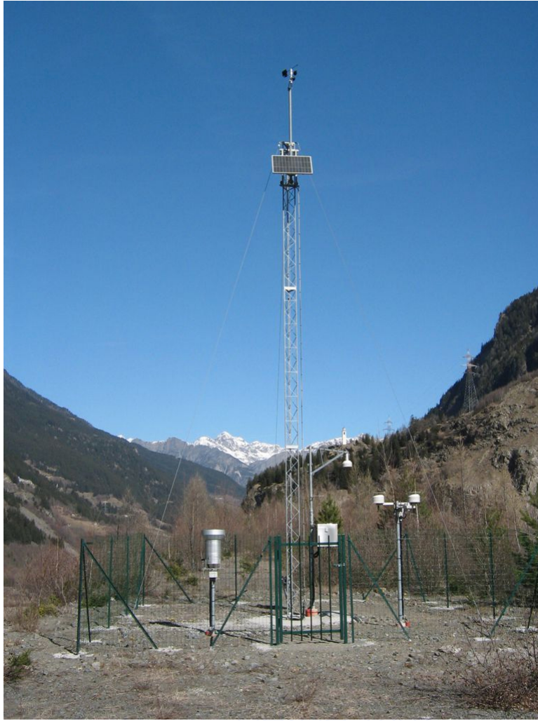
Figura 4.1: Elementos que conforman la estación SIAP+MICROS[10].
