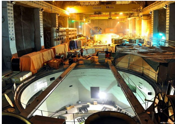
Figura 3: Casa de máquinas de la Central Paute Sopladora Fuente: (Autores, 2015)
