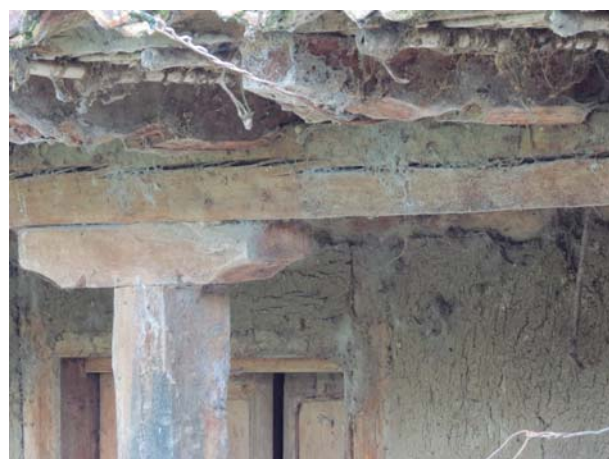
Vigas en en Proceso de Pudrición por humedad.
