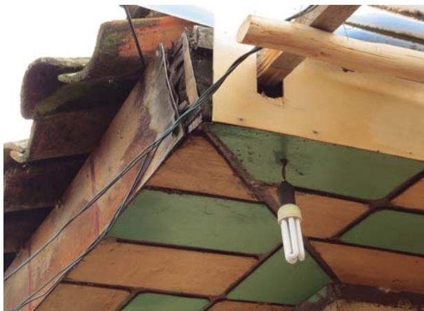
Cubierta dañada por humedad
