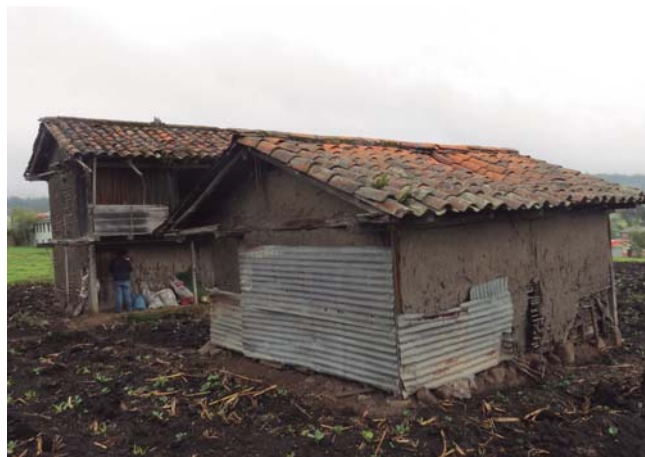
Bloques de la edificación, ambos mal estado
