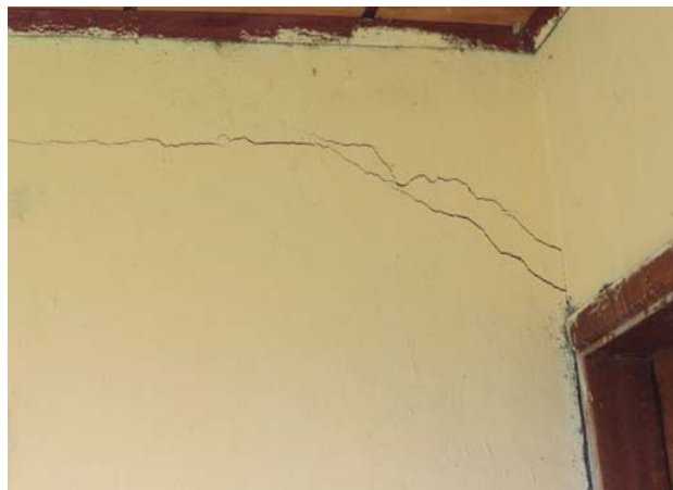
Pared con fisuras
