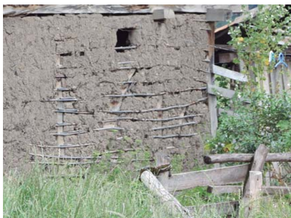
Desprendimiento de material
