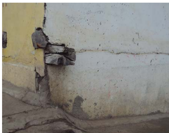
Fisuras y grietas en paredes
