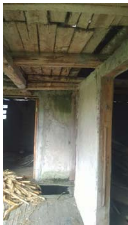
Vigas y piso podridos
