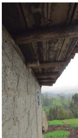
Humedad en aleros
