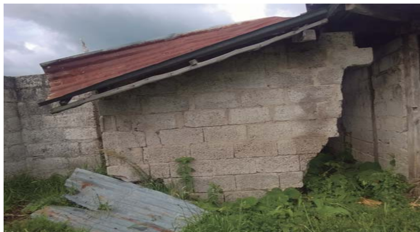
Desplomamiento de paredes
