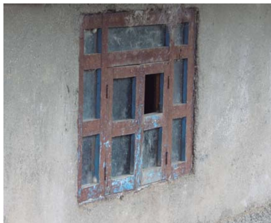
Ventanas deterioradas por el paso del tiempo
