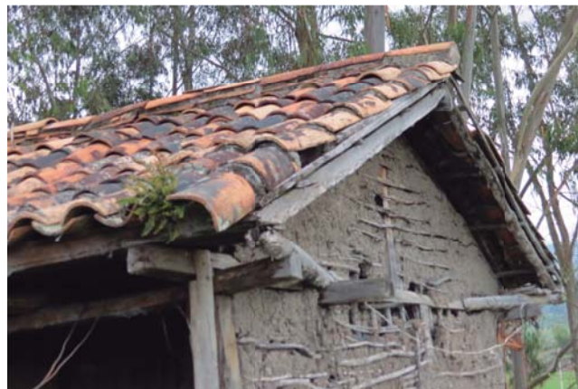
Cubierta con plantas y paredes en mal estado
