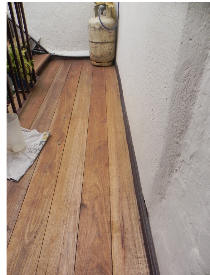
FIG 4.59: Descanso de grada después de la campaña de mantenimiento
