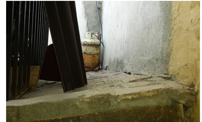
FIG 4.4: Desplome en vivienda de la manzana de San Roque
