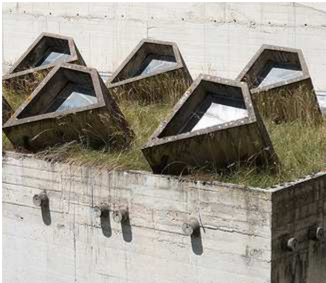
158 Iluminación para la sacristía
