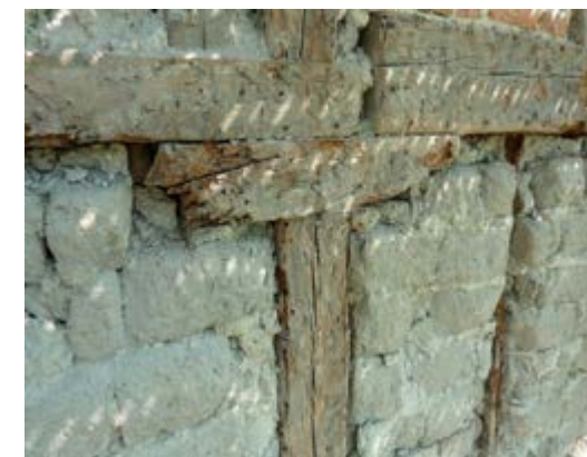
Figura 2.8. Unión riostra-columna mediante monterilla en deterioro. Vivienda vernacula de adobe y madera Madrid-España. / Fuente: Daniel Enríquez M.
