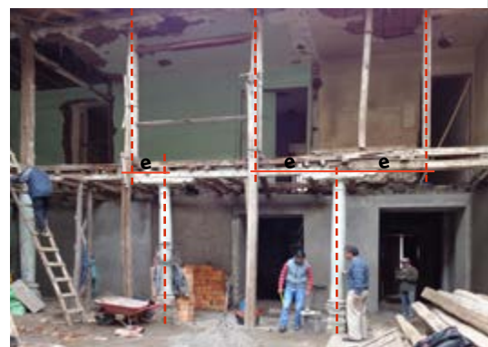
Figura 2.11. Porticos con problemas de excentricidad de cargas en columnas. Vivienda Guzman, Cuenca-Ecuador. / Fuente: Daniel Enríquez M.
