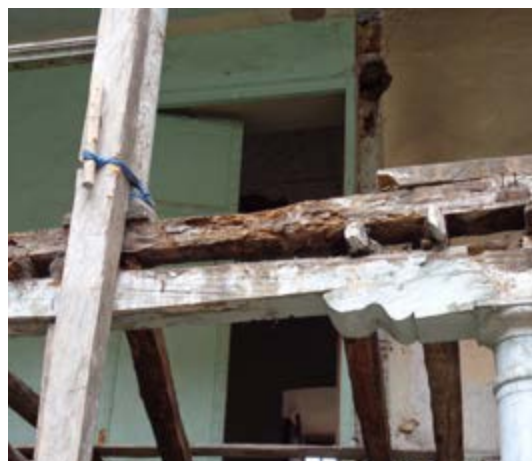
Figura 2.13. Pudrición y Deterioro en Solera y Viga. Estado actual de la vivienda Guzmán. Cuenca-Ecuador. / Fuente: Daniel Enríquez M.
