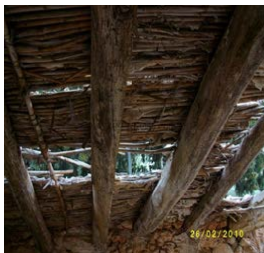
Figura 2.14. Tirantes deteriorados y presencia de xilófagos. Ermita de san Cristobal en Enguera, del siglo XVI. / Fuente: http://www.hazmeprecio.com/rehabilitacion-de-edificios/valencia
