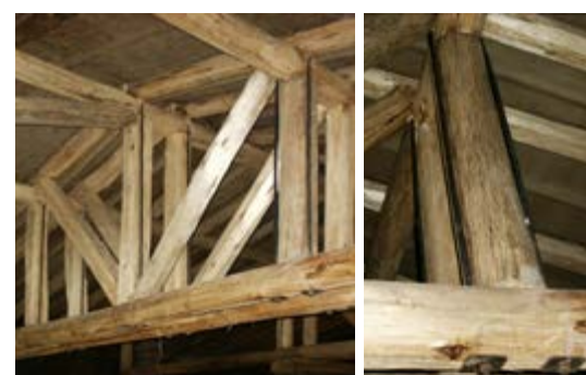
Figura 2.16. Cercha reforzada mediante hierros, refuerzos para la tracción de los tochos. / Fuente: Documentación Arq. Gustavo Lloret.2004.
