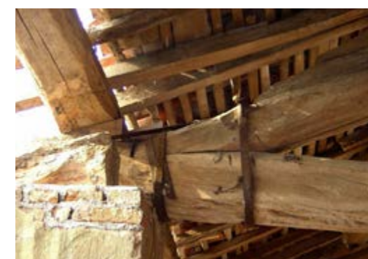
Figura 2.9. Unión viga-par en deterioro y reforzada provisionalmente con platinas metálicas. / Fuente: Zamperini, Emanuele. "Corso de recupero e conservazione degli edifici". Le strutture in legno. A.A. 2010-2011. S.I. Pág.:13
