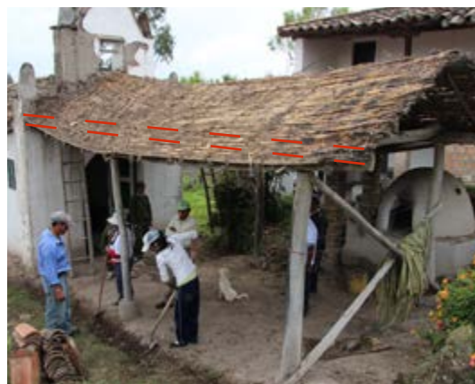
Figura 2.7. Flexión en viga de madera. Estado previo a la intervención de la capilla Susudel. Azuay-Ecuador. / Fuente: Daniel Enríquez M.
