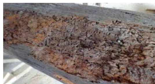
Figura 2.5. Viga de madera debastada internamente por Comején. Superficie aparentemente buena. / Fuente: Daniel Enriquez M.
