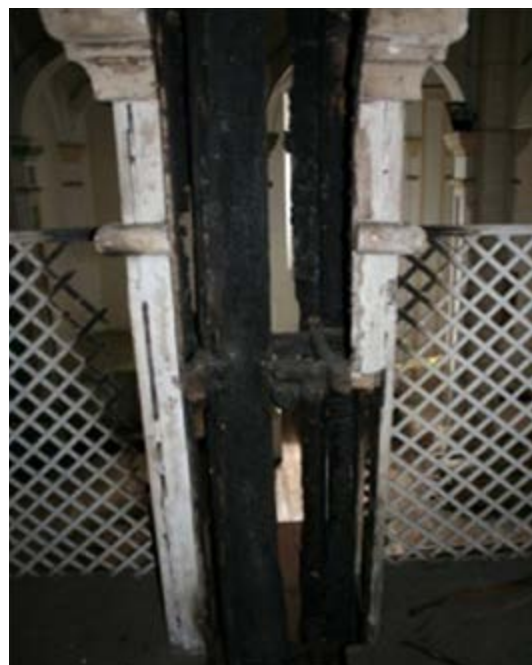
Figura 1.26. Columna de madera, después del flagelo del 2005. Iglesia Todos Santos, Cuenca-Ecuador / Fuente: Daniel Enríquez M.
